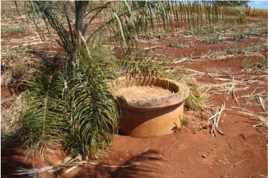
Foto 7. Um dos Pontos de Visita (PV) do sistema da sub-bacia 1.
