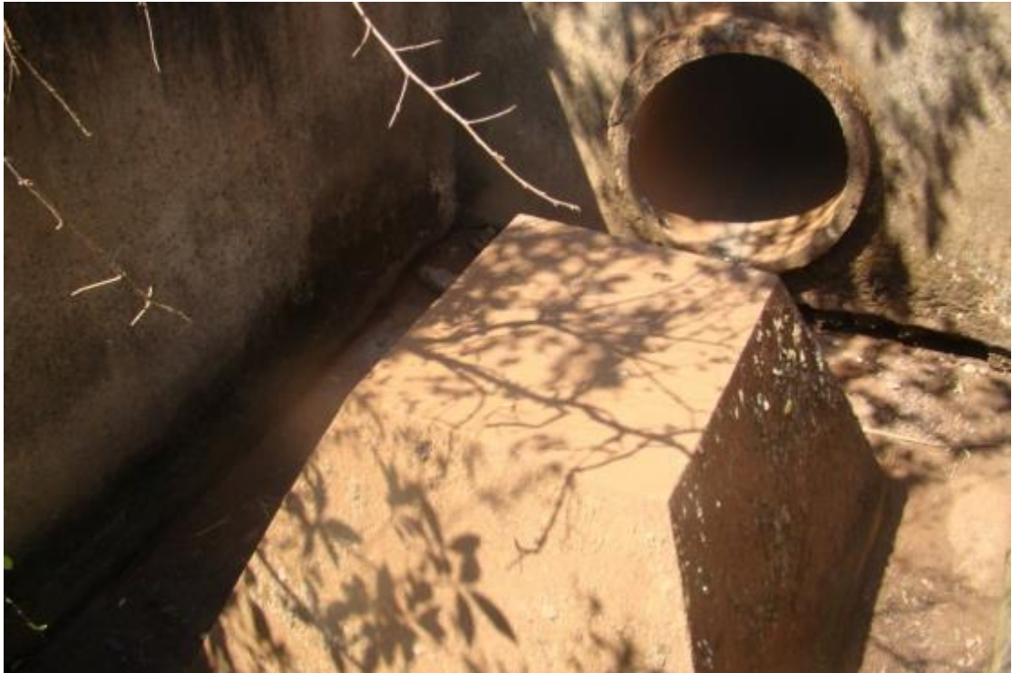
Foto 4: Tubo e dissipador do sistema de drenagem da sub-bacia urbana 1.
