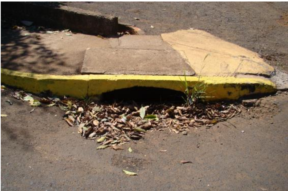
Foto 22. Boca de lobo em esquina parcialmente obstruída.
