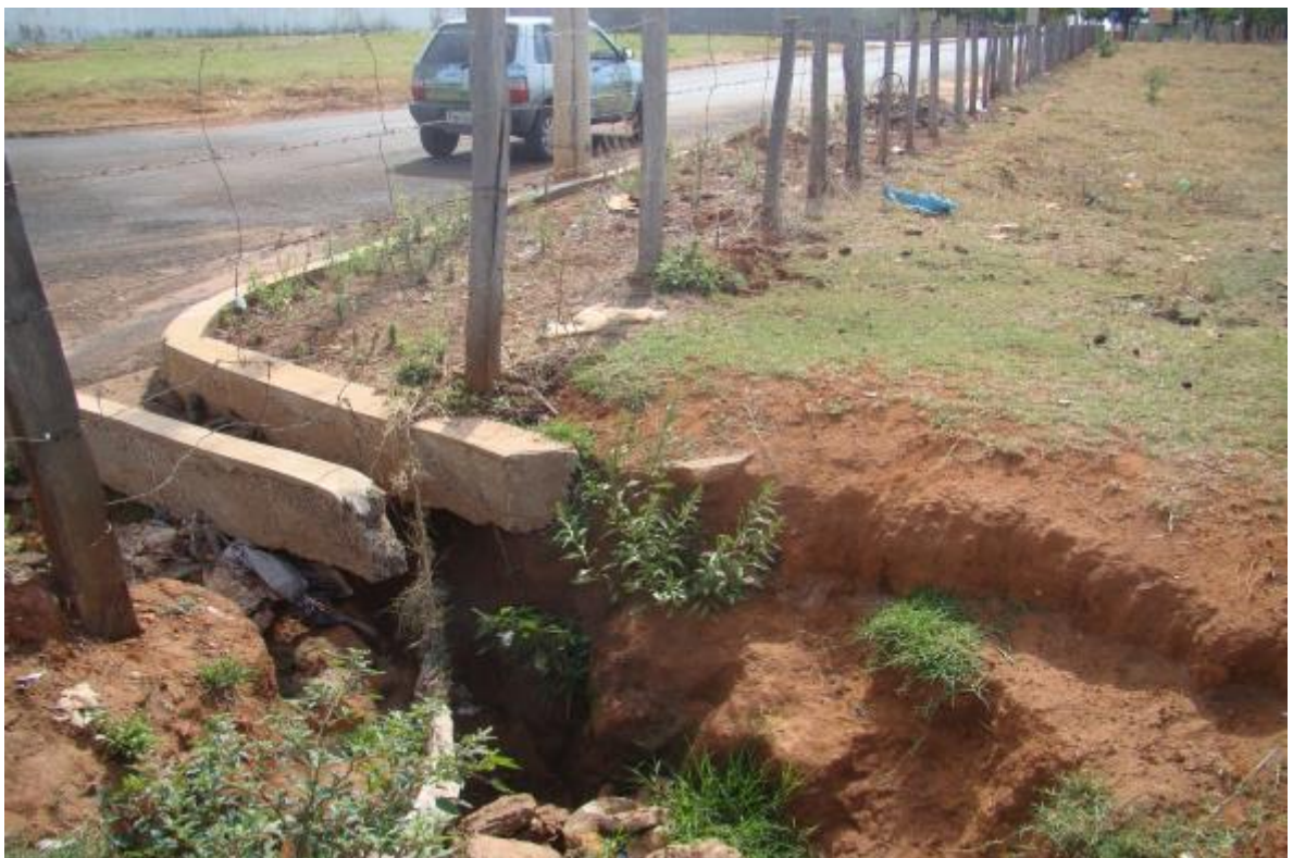
Foto 12. Detalhe do local de encontro das águas do ponto patológico, demonstrando princípio de erosão.
