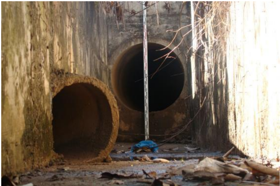
Foto 18. Detalhe frontal das duas saídas da galeria da sub-bacia 2.
