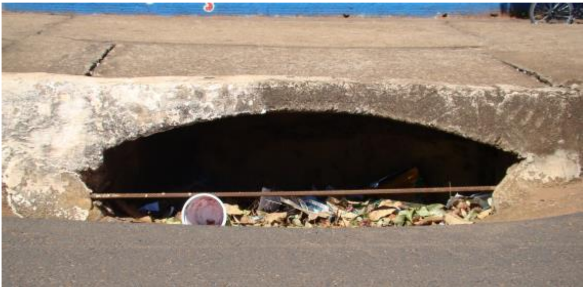
Foto 14. Boca de lobo com depressão, contendo resíduos diversos.
