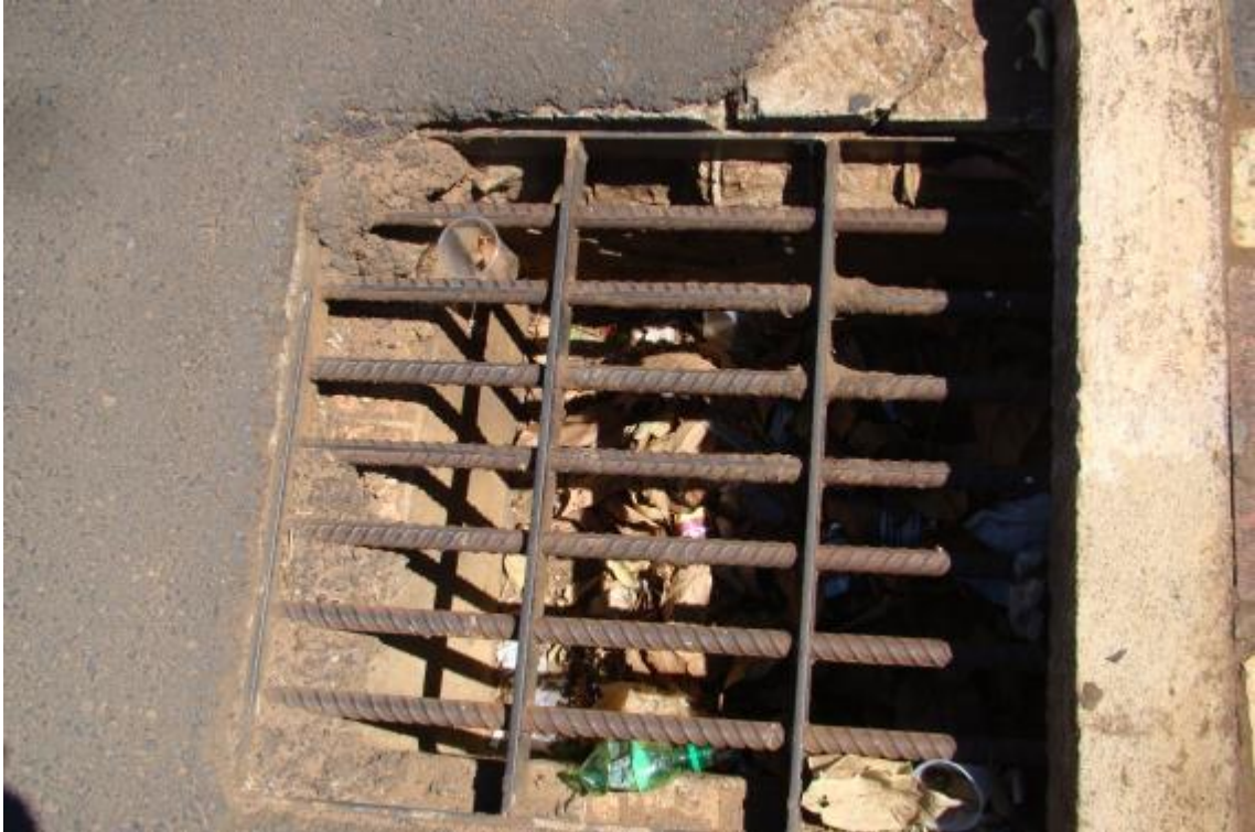
Foto 13. Detalhe da boca de lobo com grelha, contendo resíduos diversos.
