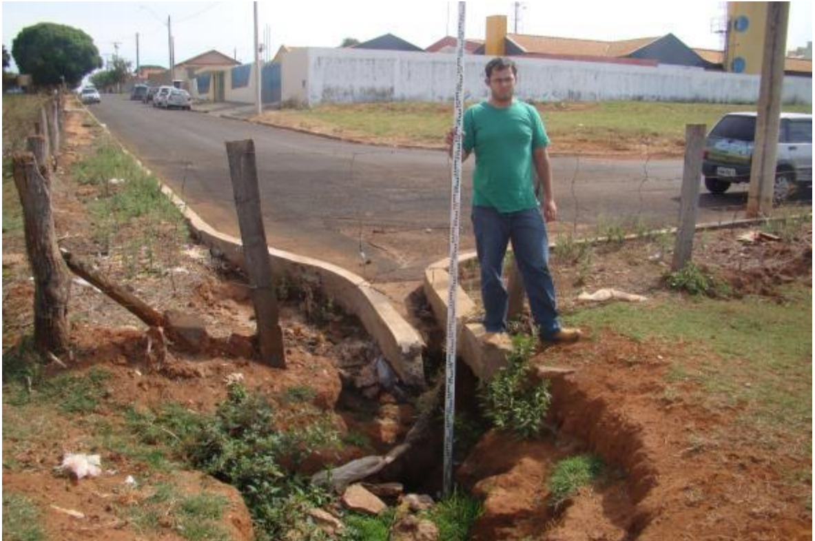
Foto 11. Local de encontro das águas do ponto patológico, demonstrando princípio de erosão.
