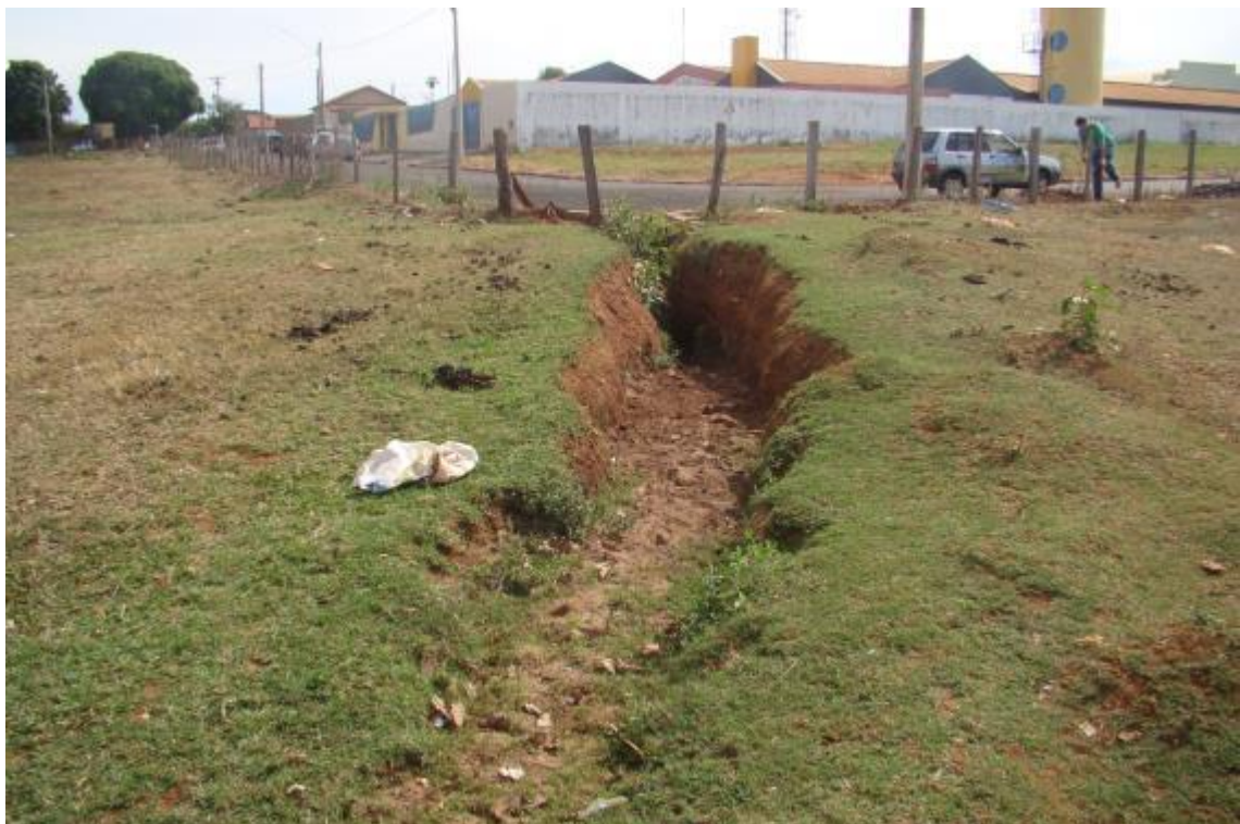
Foto 10. Local de escoamento das águas do ponto patológico, demonstrando princípio de erosão.
