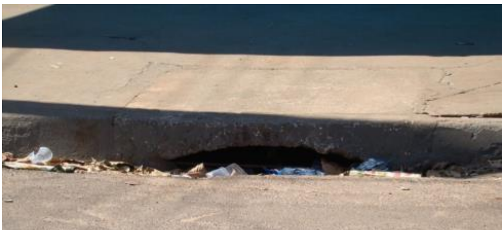
Foto 20. Boca de lobo parcialmente obstruída por resíduos.
