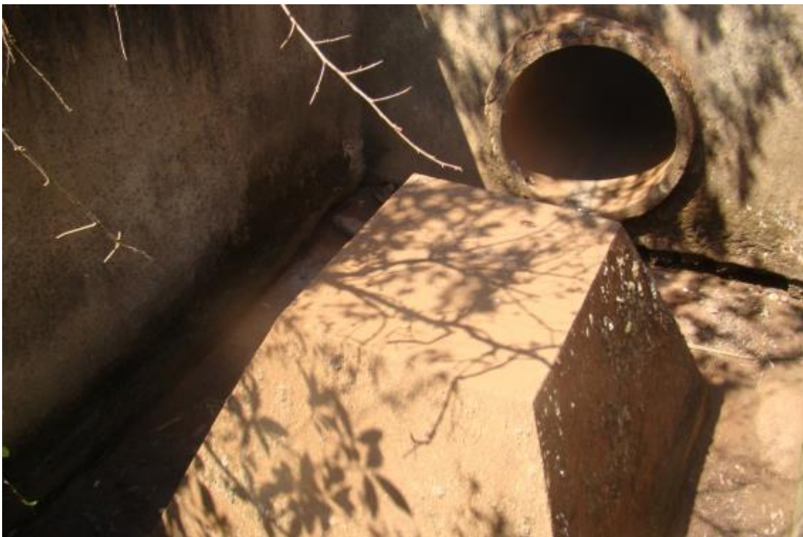
Foto 6. Tubo e dissipador do sistema 1 de drenagem da sub-bacia urbana 1.
