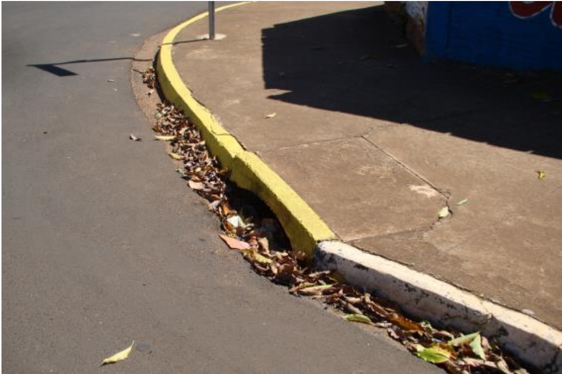
Foto 21. Boca de lobo em esquina, parcialmente obstruída.
