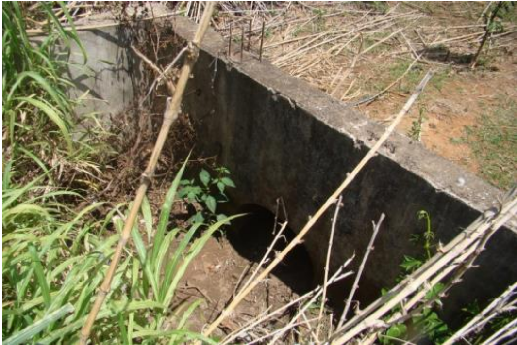
Foto 15. Dissipador do sistema 2 da sub-bacia 1.
