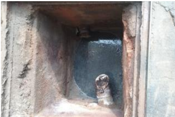
Foto 41: Lodo residual da ETE da indústria DuCreme.
